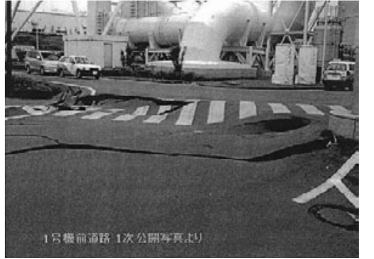
写真③ 新潟県中越沖地震で道路が損壊した（2007年7月16日）
