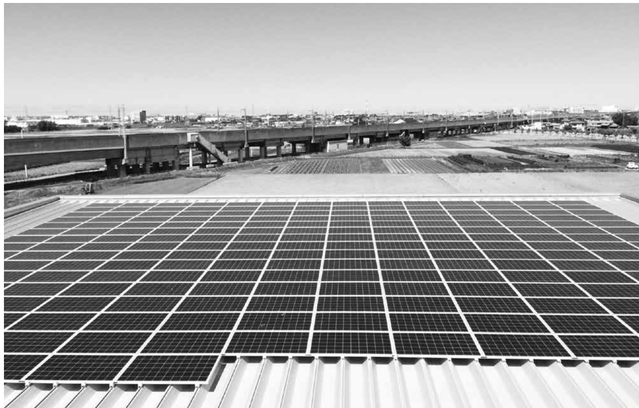
おらって発電所 第1号機竣工（黒崎市民会館）（2015年9月23日）
