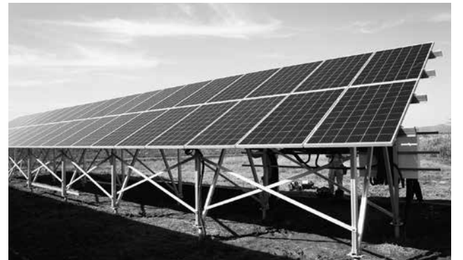
第1号発電所「小矢部清水太陽光市民発電所」が完成（2017.11.7）
