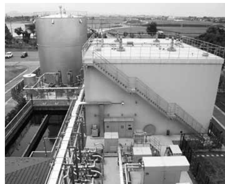
メタン発酵槽
