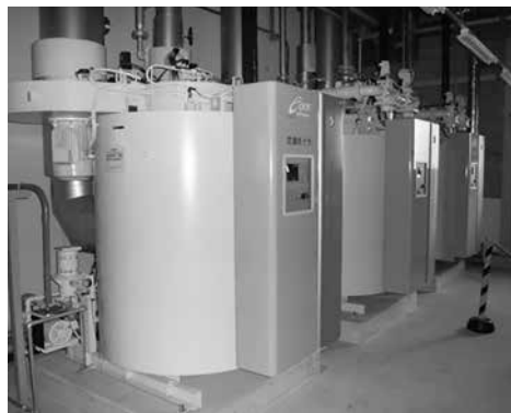
バイオガスボイラー
