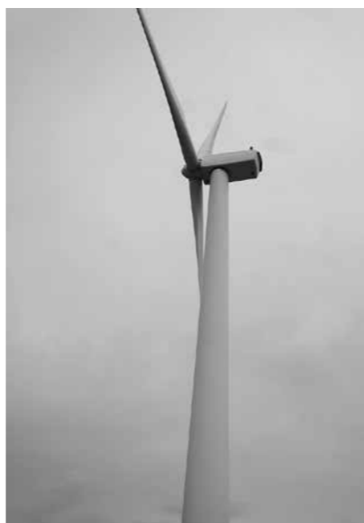
入善町浄化センター風力発電施設
