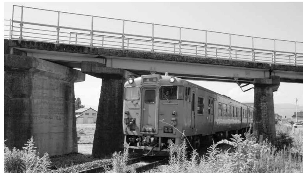
廃線後サイクリングロードとなっている旧加越線の遺構(立体交差)をくぐる城端線
